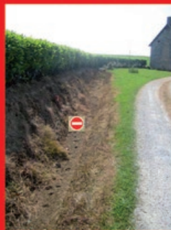
Les fossés, même à sec
